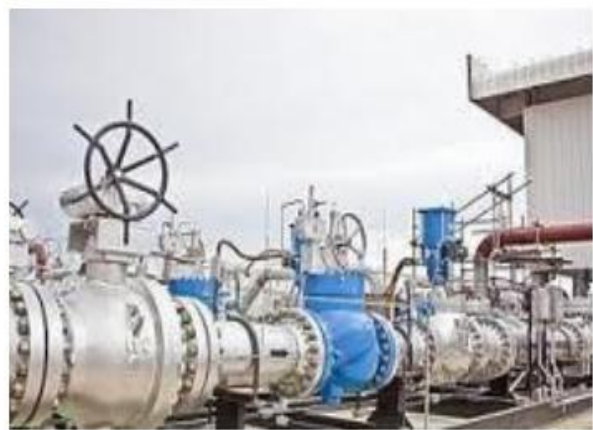
Transporte Duto viário de gases
